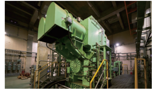
② 低圧採取設備 ガス田の圧力低下に伴い、生産量を最大化するために導入した設備です。
