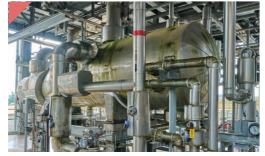
⑤ 露点調整装置 天然ガスを安全にパイプラインへ送れるよう、冷却して露点を調整。パイプライン内での液体分の凝集を防ぎます。
