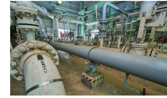
⑥ 送出マニホールド室 精製・処理された天然ガスは、パイプラインを通じて都市ガス事業者などの各需要家へ送られます。
