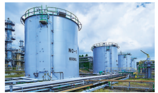
⑧ コンデンセートタンク プラントで生産した油をタンクに保管します。
