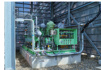
Aから供給される水素ガスを反応に有利な圧力(1.3 MPaG)まで昇圧します。
