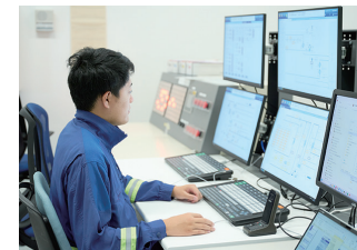
実証設備に必要な電力を供給し、中央制御室から実証設備全体を遠隔制御します。
