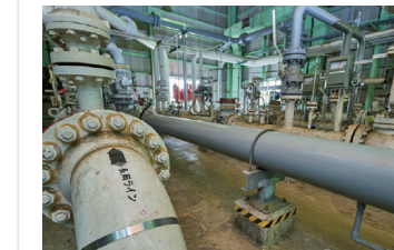
実証設備で製造した合成メタンを既設の処理設備で精製・昇圧して導管注入します。
