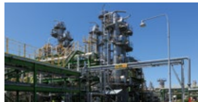
南長岡ガス田(越路原プラント)
