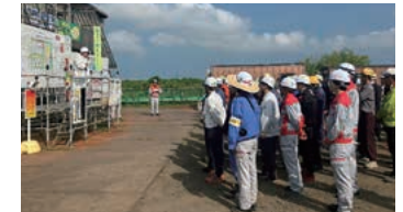
柏崎水素パーク建設現場における コントラクターとの対話
