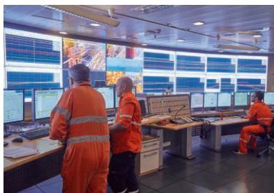
CPF内のコントロールセンター
