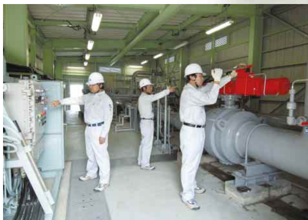
緊急遮断弁の作動確認
