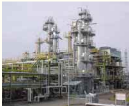
親沢プラント ガス処理施設
