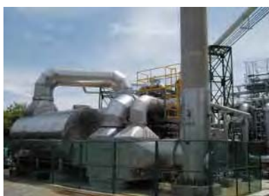
越路原プラント VOC除去装置
