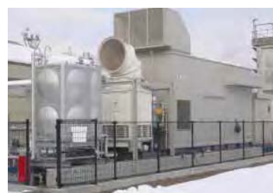
コージェネレーションシステム
