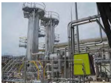
越路原プラント 不純物除去装置
