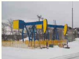
八橋油田 ポンプユニット
